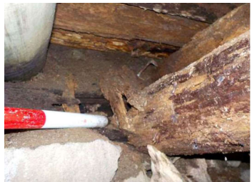
木桁・腐朽（奥ノ谷3号橋）
