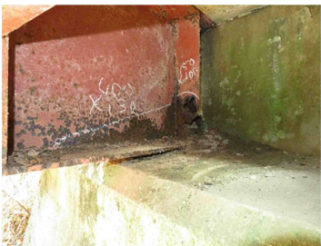
鋼桁・腐食（原背橋）
