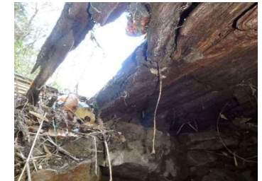
床版・抜け落ち（オクタニ橋）
