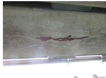
PC桁・錆汁（別所橋）
