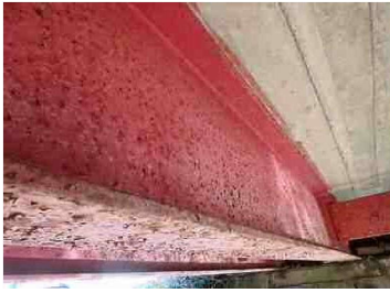
鋼桁・腐食（鳥居田橋）
