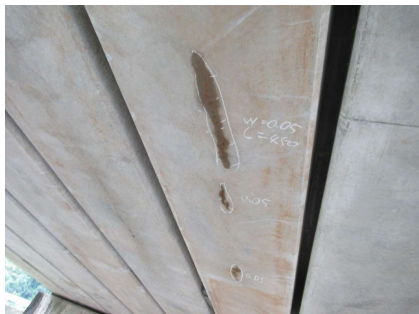
PC 主桁のひび割れ、漏水
