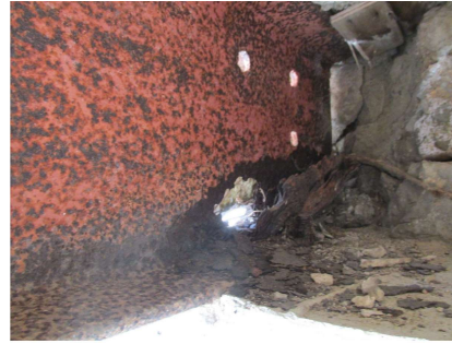
支承付近の孔食
