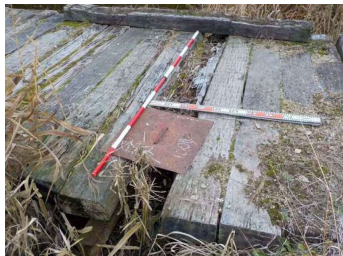
床版・抜け落ち（藤田橋）
