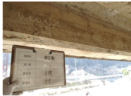
PC 主桁の浮き
