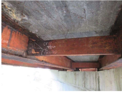
鋼製床組みの腐食
