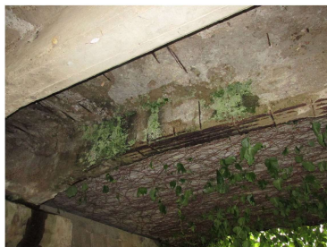
RC桁・剥離（会館橋）
