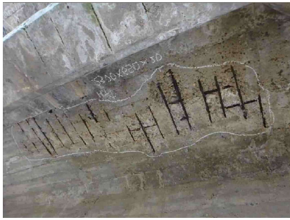
RC 床版の剥離・鉄筋露出
