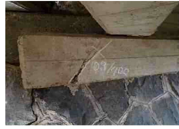
RC橋台・ひび割れ（金平橋）
