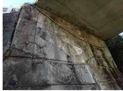
RC 橋台のひび割れ
