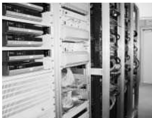
ケーブルテレビセンター設備
