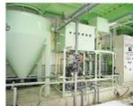
排水処理装置
