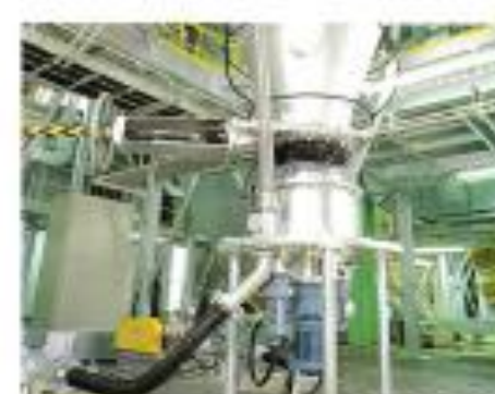
有害ガス除去装置
