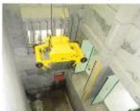
ごみピット・ごみクレーン
