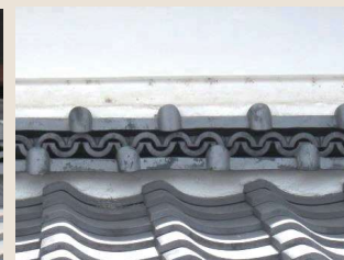
F 棟込み瓦が輪違い (70)
