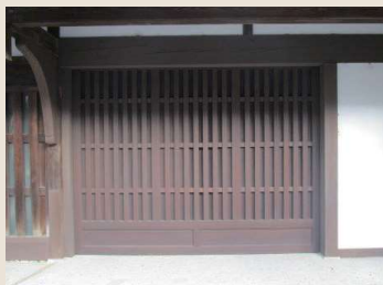
H1(扉を下ろした状態)
