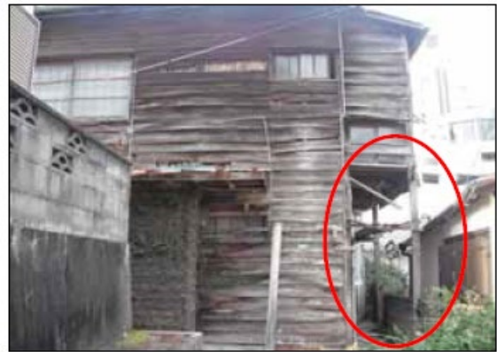
柱に局所的な亀裂やひび割れ等がある例 (柱、はり、筋かい、柱とはりの接合等)
