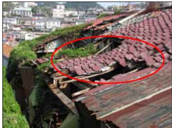
屋根、ふき材が剥落している例 (屋根ふき材、ひさし又は軒)
