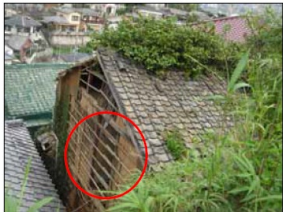
外壁の仕上げ材料が剥落、腐朽又は破損し 下地が露出している、 壁体を貫通する穴がある例 (外壁)
